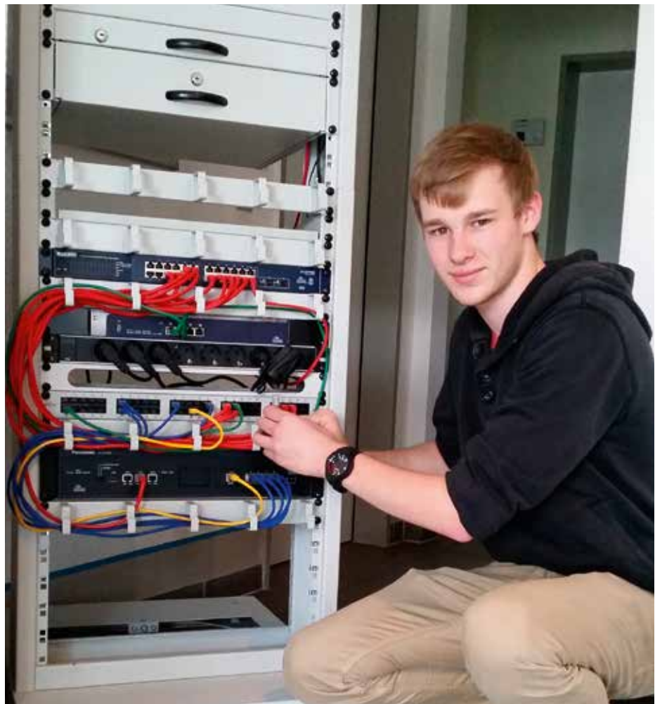
Foto: STADEL Telekommunikation & IT-Systeme
